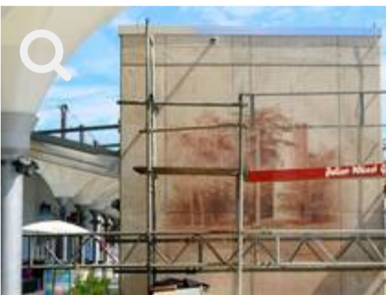
Der Wartturm als Wandmalerei: Das Buchener Wahrzeichen ziert die Außenfassade des neuen Aufzugsturms am Einkaufszentrum am Sendeturm. Foto: Rüdiger Busch
